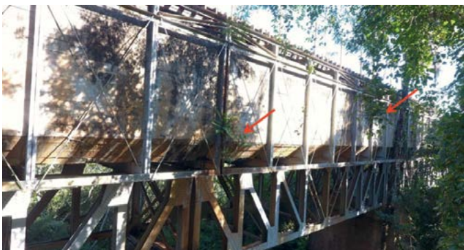
FIGURA 4 – Foto feita com drone mostra locais com corrosão e crescimento de vegetação na lateral da estrutura metálica (setas)
