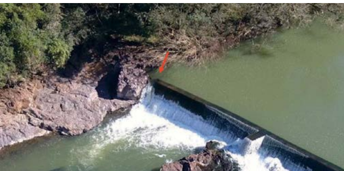
FIGURA 6 – Região do contato com ombreira direita, onde o fluxo é mais intenso
